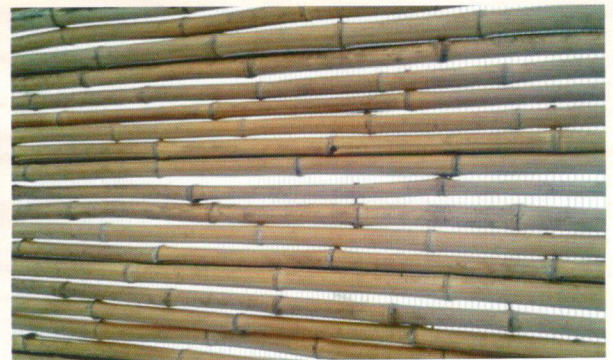
Fotografía 11. Cielo raso temporal en guadua
