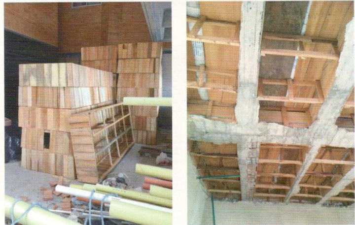
Fotografía 4. Casetones en madera, utilizados para fundir la placa y retirados posteriormente. Generalmente alquilados
